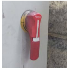
Manette de mise hors tension
